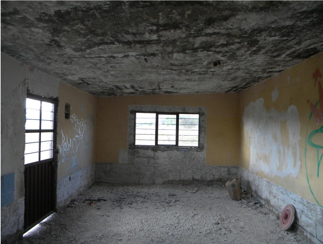
FOTO DE ANTES DE DAR MANTENIMIENTO CORRECTIVO A PAREDES Y TECHO AL EDIFICIO DE BIBLIOTECA
